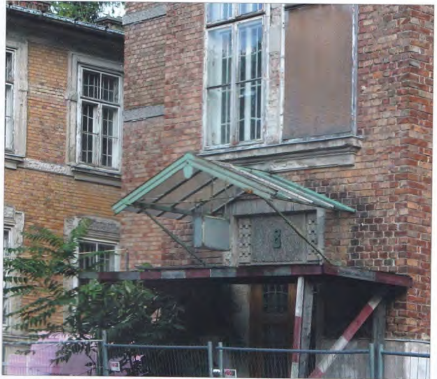
Der Pavillon 8 ist seit Jahren vom Verfall bedroht (Foto 2016).
