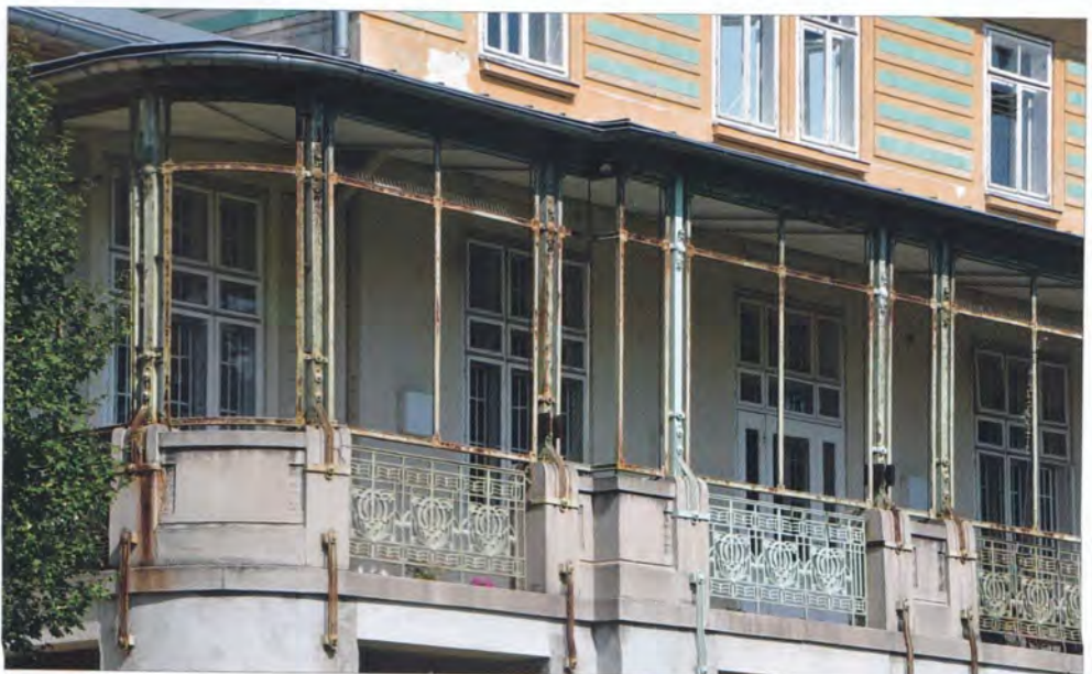
Rostschäden an einer kunstvoll gestalteten Terrasse (Foto 2016).
