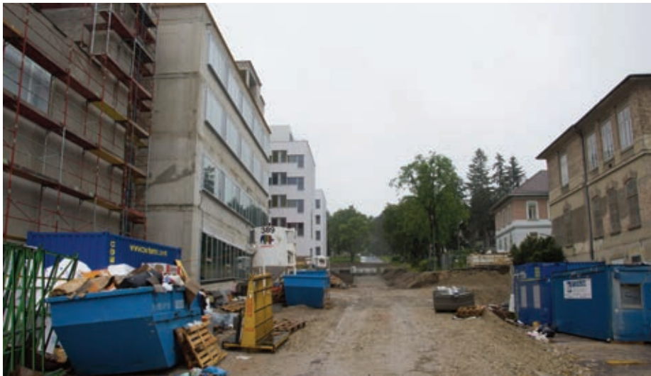
Abb. 14: Neue Bauteile (links) in Disharmonie zum historischen Bestand (rechts)
