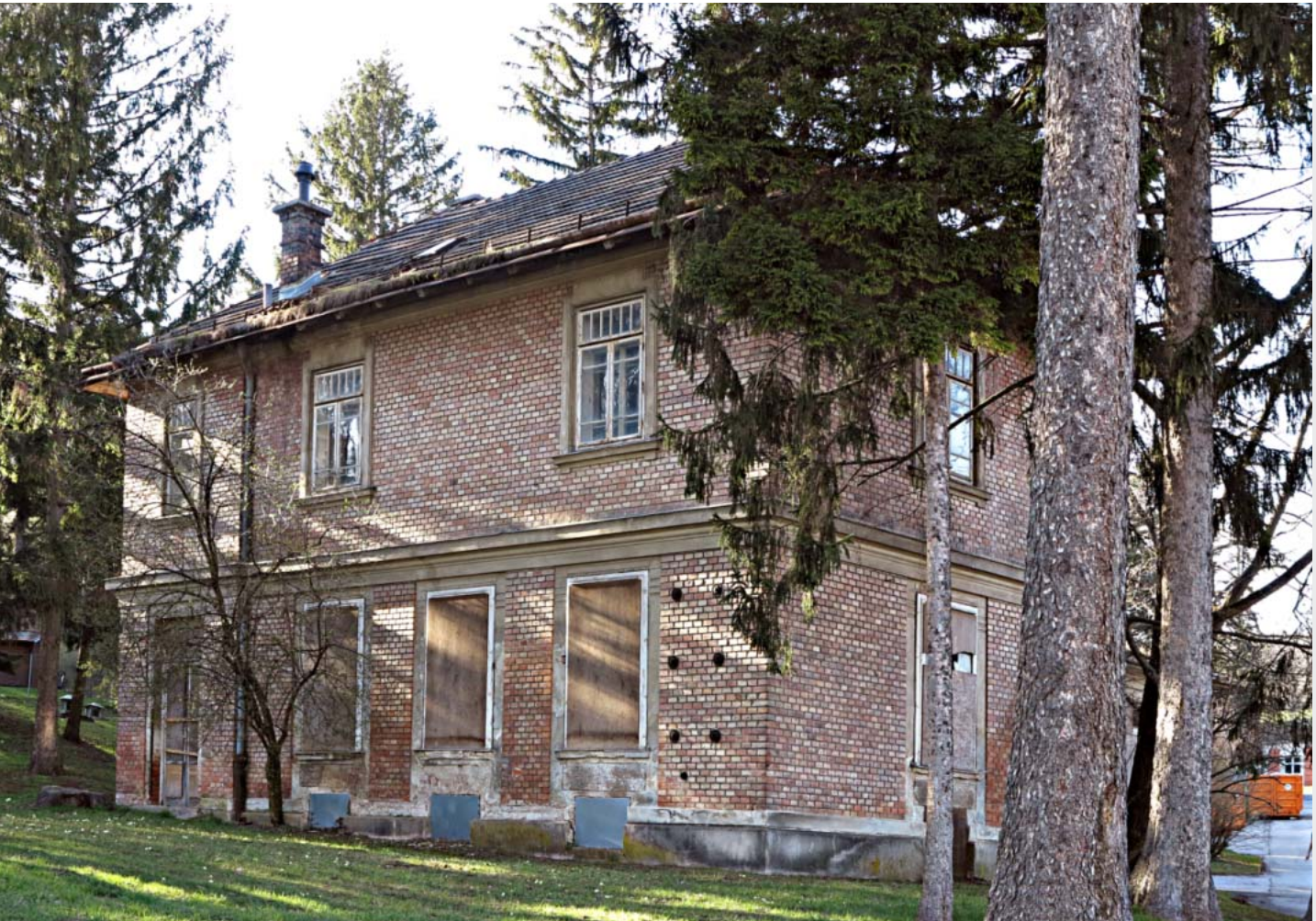
Abb. 4: Die ehemalige Fleischerei ist der letzte erhaltene Wirtschaftsbaus aus der Zeit Otto Wagners, an dem das ganzheitliche Konzept einer Selbstversorgung und einer gleichzeitigen Beschäftigungstherapie für Patienten ablesbar ist. Das Gebäude ist akut vom Abbruch bedroht.
